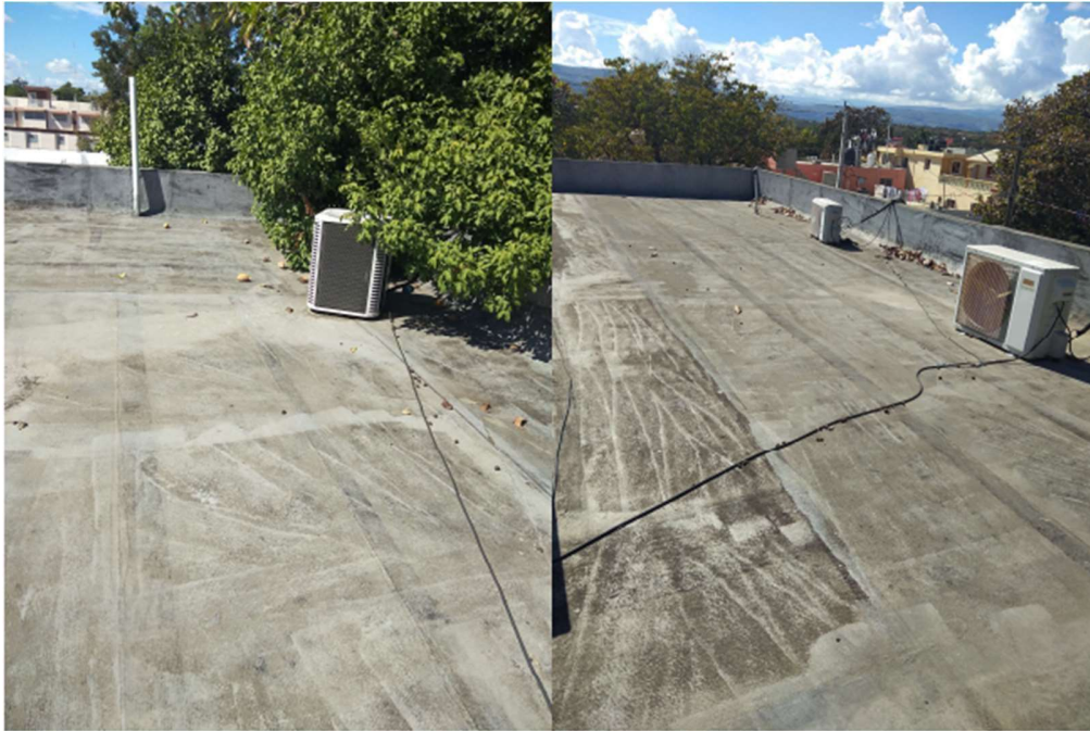
Ilustración 7. lona asfáltica deteriorada las matas de farfán.
