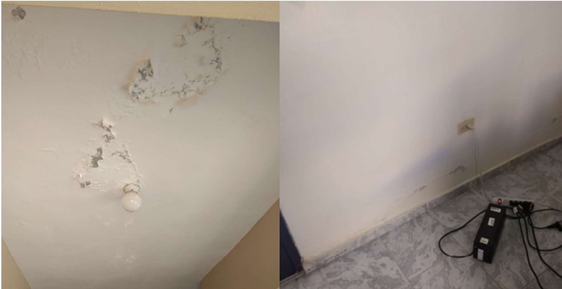
Ilustración 1. Filtraciones en techo
