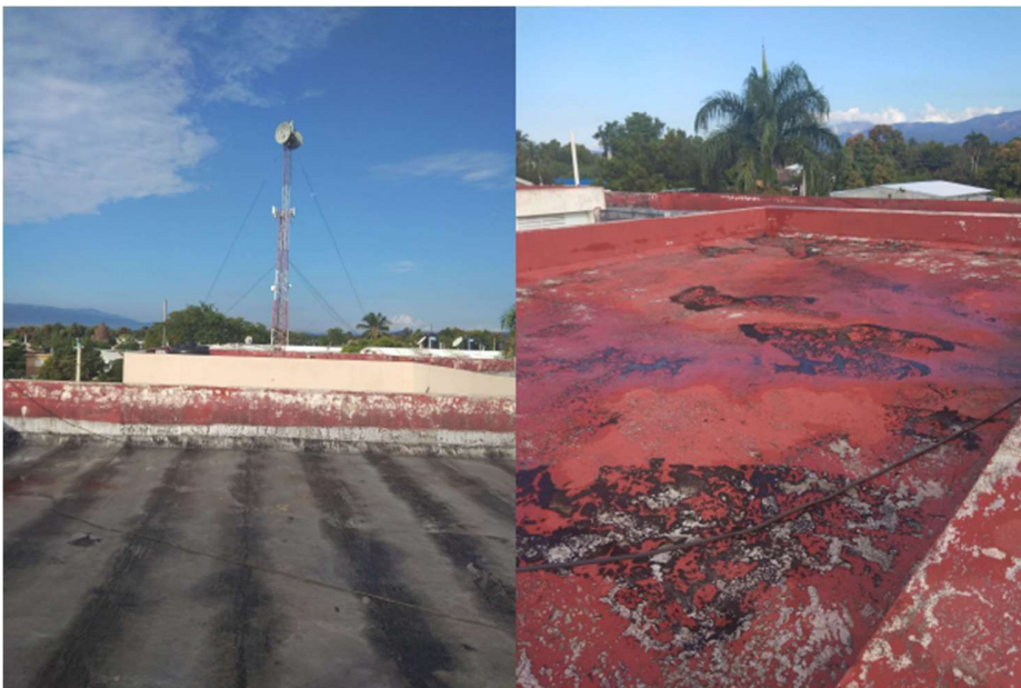
Ilustración 10. Techo de azua lona asfáltica deteriorada.
