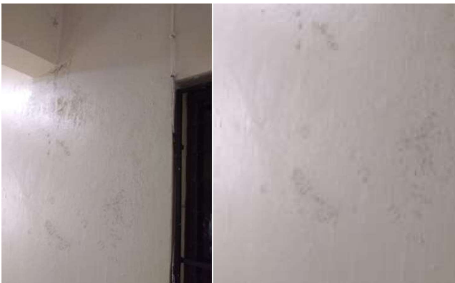
Ilustración 8. Daños en pintura de las paredes por filtración
